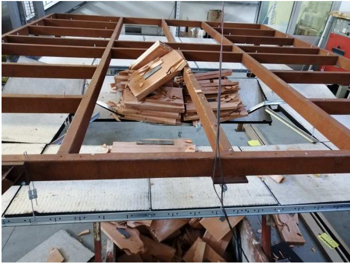
Fotografia della superficie d'estradosso della porzione di controsoffitto "A" dopo l'impatto n. 11
